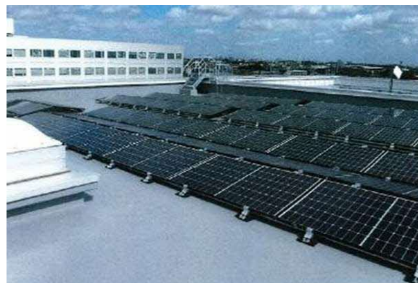
屋上に設置している太陽光パネル
