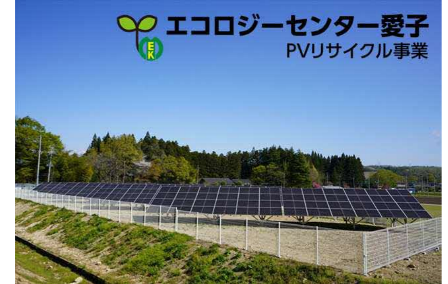
太陽光パネルリサイクル施設太陽光設備 (発電77.76kW、蓄電10kWh)
