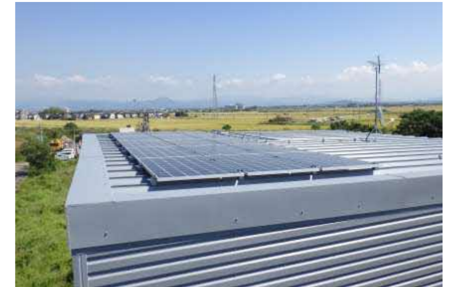
倉庫（太陽光発電機設置状況）
