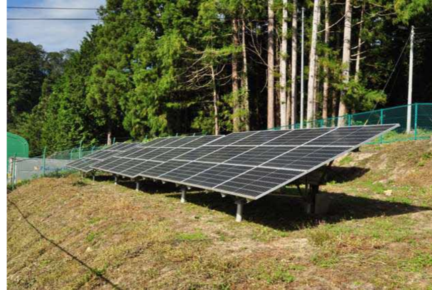
本社太陽光設備 (パネル発電21.9kW、蓄電16.8kWh)
