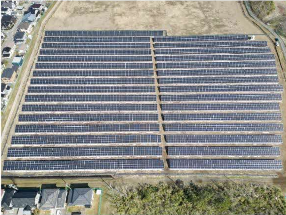
写真：柏崎松波太陽光発電所
